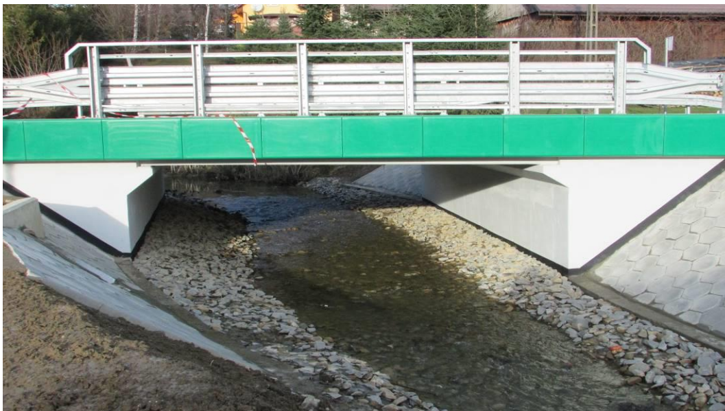
Fot. Most na potoku Łubianka w km 2+701 w ciągu drogi powiatowej Nr 1428R po wykonaniu prac związanych z jego remontem
