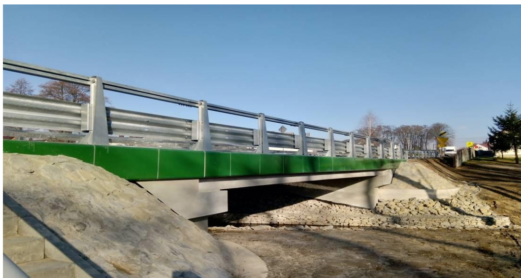
Fot. Most na rzece Żyłka w ciągu drogi powiatowej Nr 1237R po wykonaniu prac związanych z jego remontem
