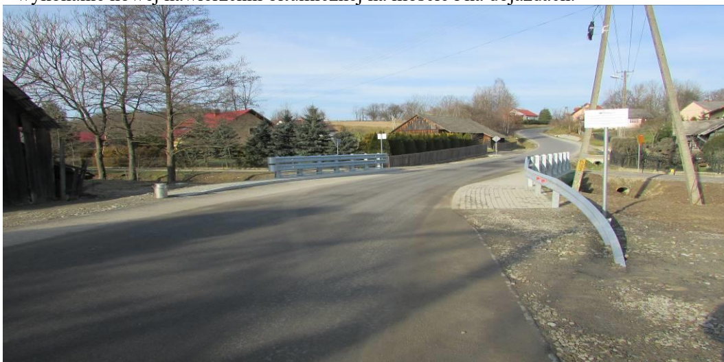
Fot. Most na potoku Łubianka w km 6+063 w ciągu drogi powiatowej Nr 1428R po wykonaniu prac związanych z jego remontem
